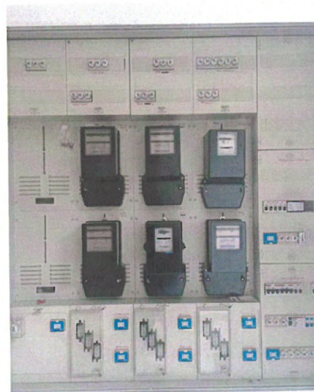
Hauptverteilung/ Zählerplätze Spitalstr. 5/1
