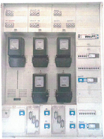
Hauptverteilung/ Zählerplätze Spitalstr. 5
