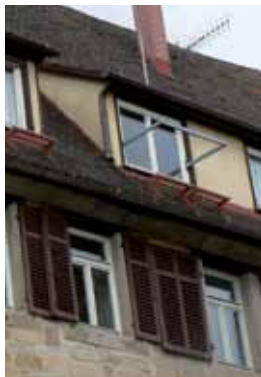
Umwehrungen für Dachaustritte, die im Regelfall nicht erforderlich sind
