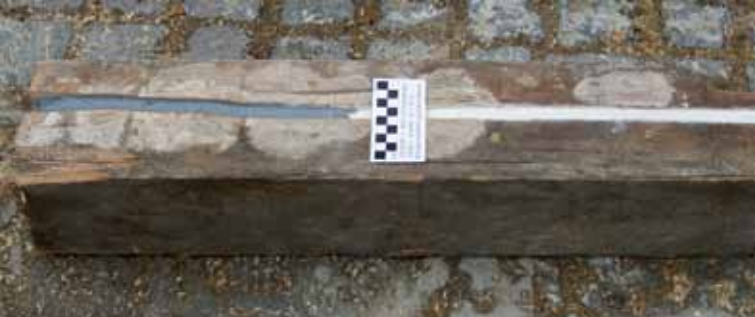
Prüfstück mit unterschiedlichen Füllmaterialien in großen Rissen
