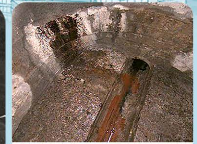
Eindringendes Grundwasser Dichtheitsprüfung nicht bestanden
