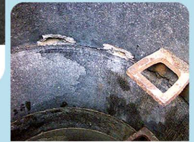
Schachtwandung defekt - Ausbruch Dichtheitsprüfung nicht bestanden
