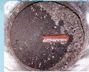
Schachtsohle schadhaft bzw. nicht fachgerecht Dichtheitsprüfung nicht bestanden
